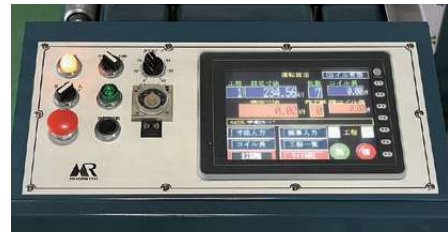
操作パネル/100工程操作パネル
